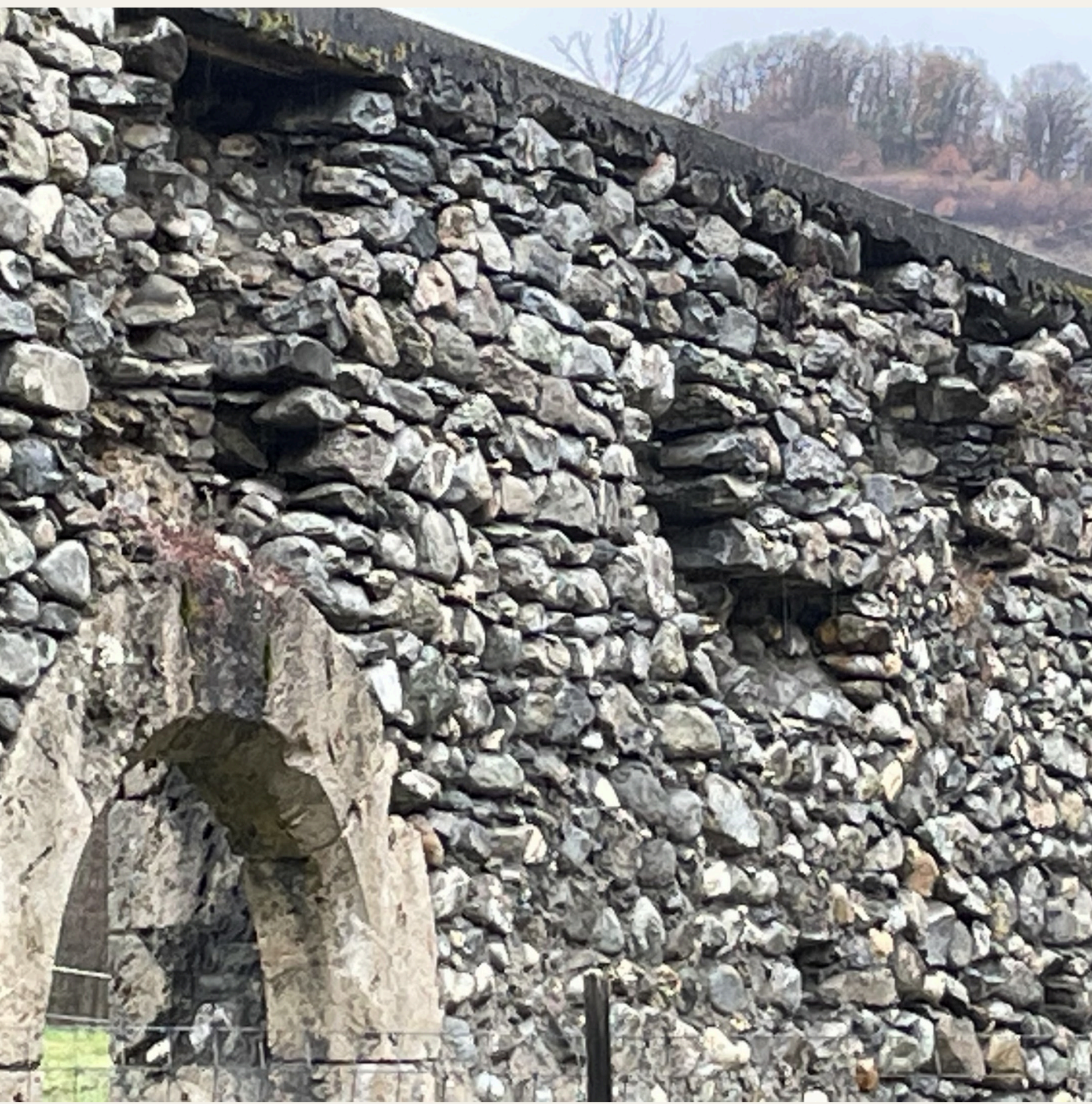
Le mur nord du cloître : les maçonneries se déforment, les arcs se fissurent.
